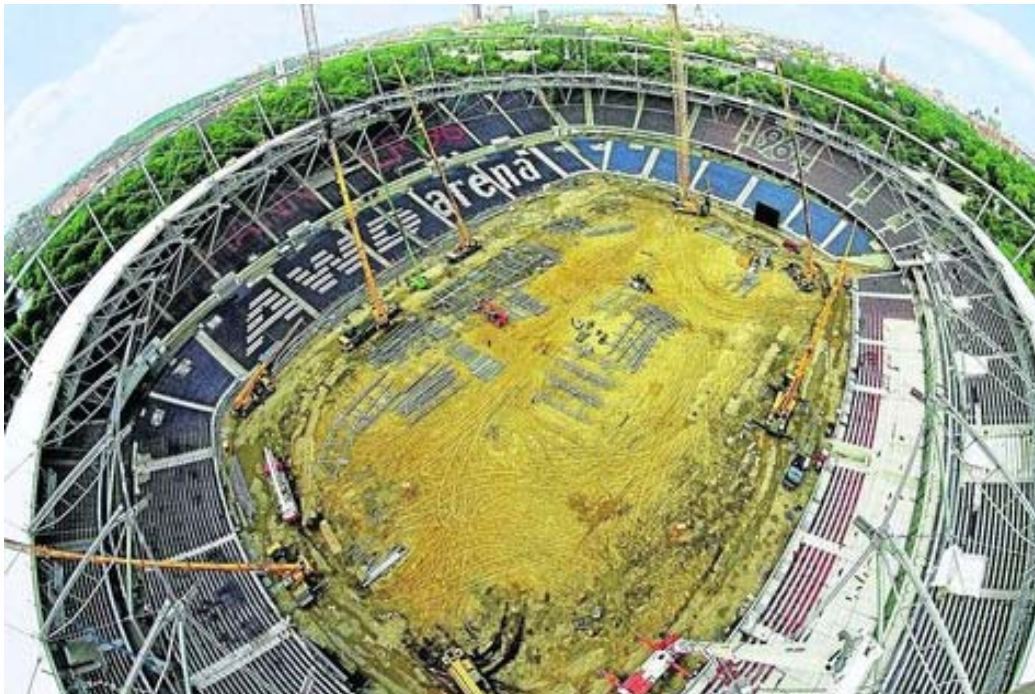
Technik auf hohem Niveau: Ingenieure von FERCHAU Engineering haben Thyssen Krupp bei der Entwicklung des neuartigen Dachsystems an der AWD-Arena in Hannover unterstützt. Foto: nh
